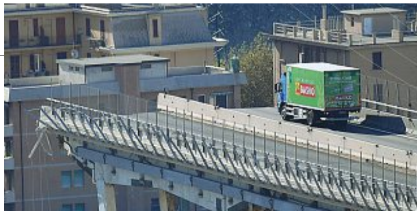
Ponte Morandi Il 14 agosto 2018, a seguito del crollo parziale della struttura, sono morte 43 persone, 566 gli sfollati. Verrà ricostruito
